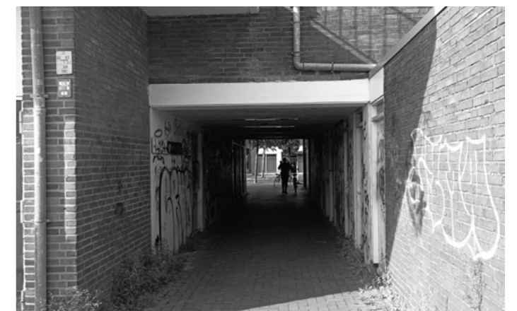
Afbeelding 84: Conditie van verbindingsgang
